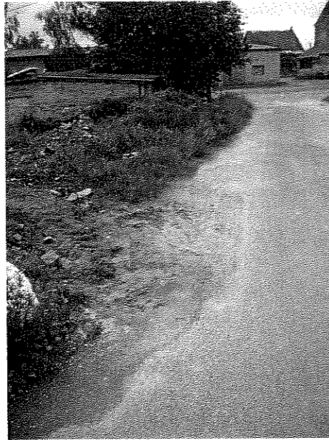
Zdjęcie nr 24. Stan techniczny nawierzchni w Gołostowicach.
