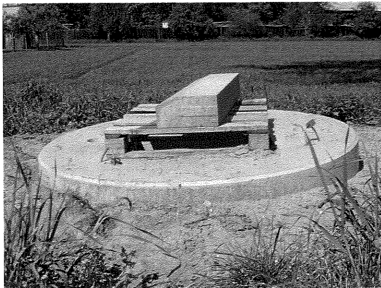
Zdjęcie nr 5. Przepompownia sieciowa w Prusach.
