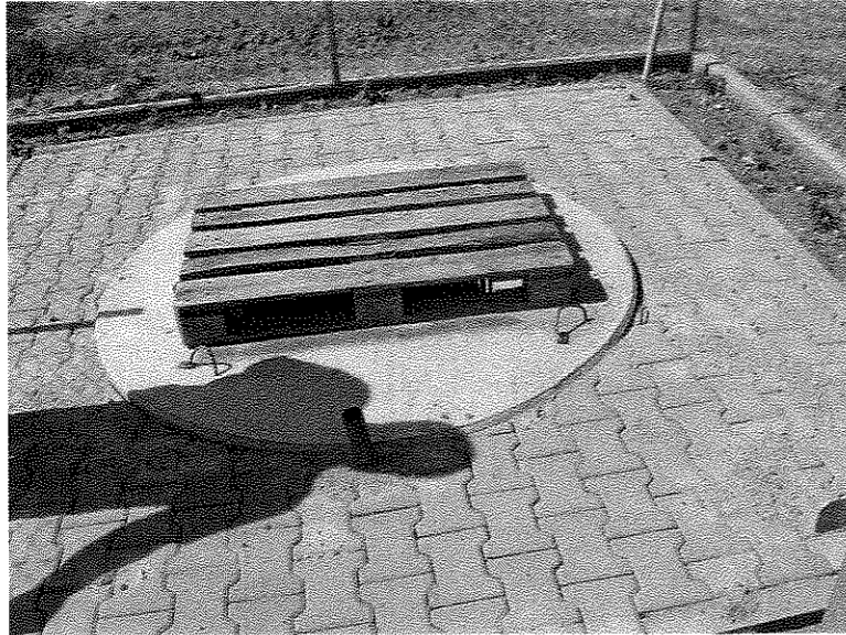
Zdjęcie nr 8. Przepompownia sieciowa w Gołostowicach.
