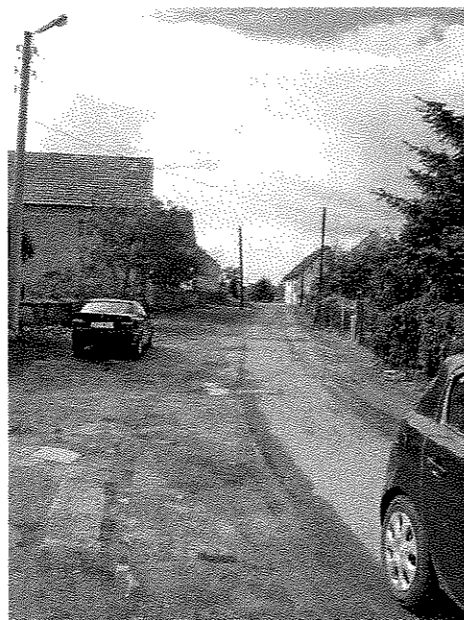
Zdjęcie nr 20. Stan techniczny pobocza w Karczynie.
