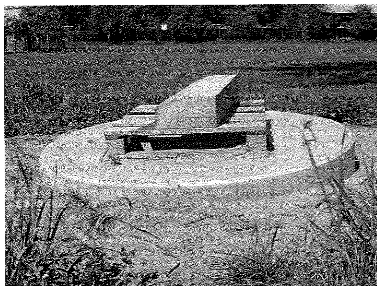
Zdjęcie nr 5. Przepompownia sieciowa w Prusach.
