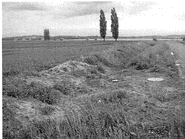
Zdjęcie nr 15. Stan techniczny pobocza w Karczynie.
