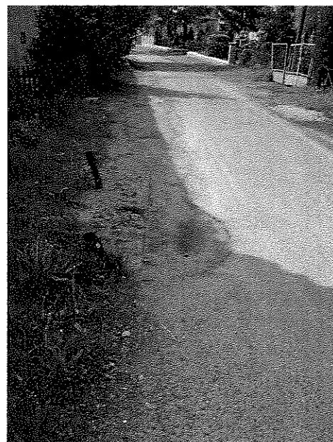
Zdjęcie nr 19. Stan techniczny pobocza w Karczynie.
