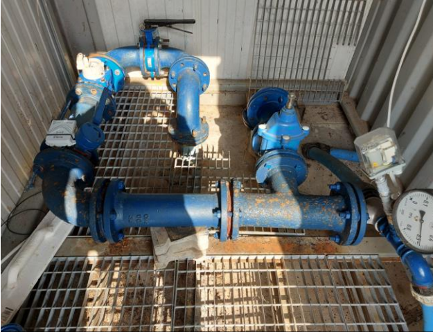
Pomieszczenie przepływomierzy i rozdziału strefowego
